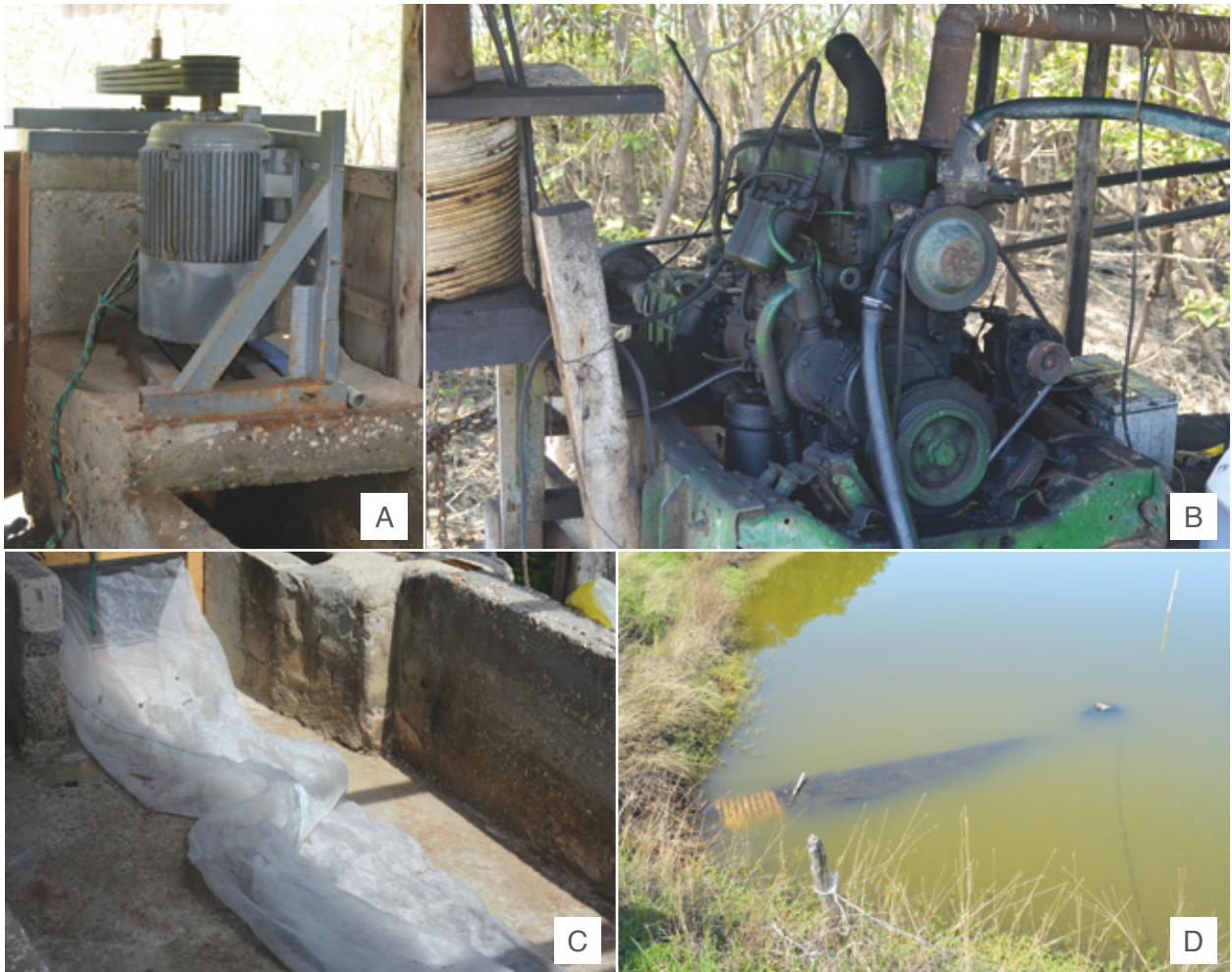
Figura 13. Equipo empleado en las fincas de cultivo de camarón. A) Bomba eléctrica, B) Bomba de motor diésel, C) Filtro al ingreso de la estación de bombeo y D) Filtro de los estanques (Fuente: elaboración propia con fotografías de Silvia Ramírez)
